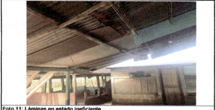
Foto 11: Láminas en estado ineficiente.
