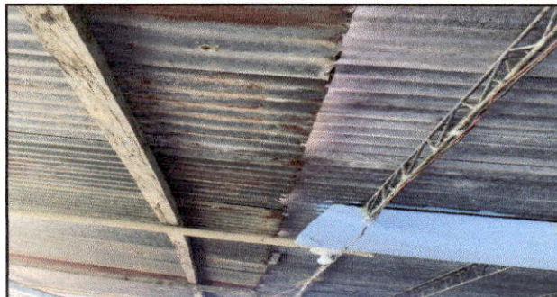
Foto 5: Estructura y techo en malas condiciones.
