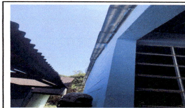
Foto 4: Techo de lamina en mal estado.
