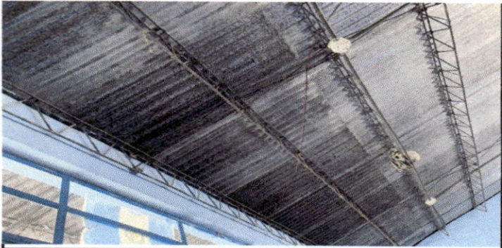
Foto 8: estructura de lamina en mal estado por corrosión.
