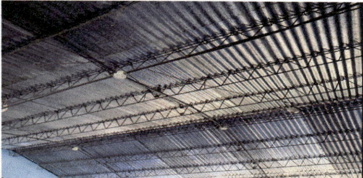
Foto 10: Lamina en mal estado por corrosión.
