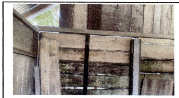
Foto 6: Estructura de madera en mal estado.
